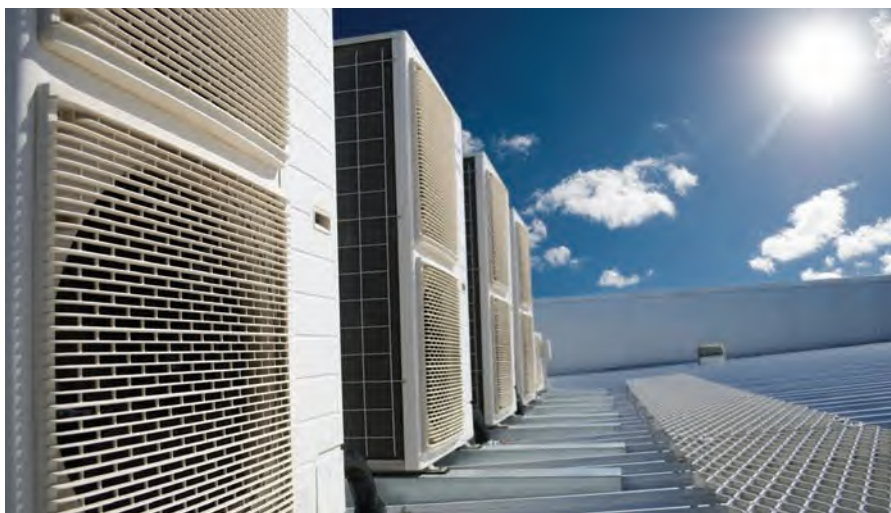
ساخت و سازه‌های فراوان در تمام کشورهای شورای همکاری خلیج فارس علت تقاضا در بازار گرمایش، تهویه، تهویه مطبوع و تبرید (HVAC) است. (عکس: ZakS Photography/Shutterstock)
